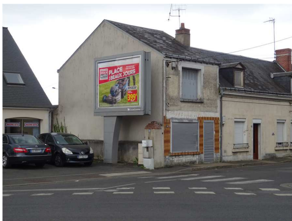
Publicité scellée au sol implantée à une distance inférieure à la moitié de la hauteur du dispositif (H/2) de la limite séparative
